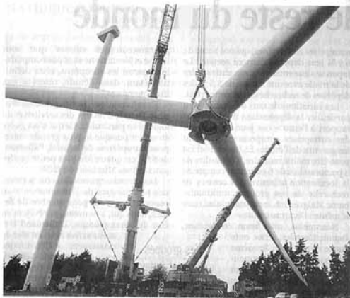
Vingt-six éoliennes, d'une puissance unitaire de 1,5 mégawatt (MW), ont été installées dans le village d'Ally, en Haute-Loire. ETIENNE DE MALLAIGNE/GAMMA
